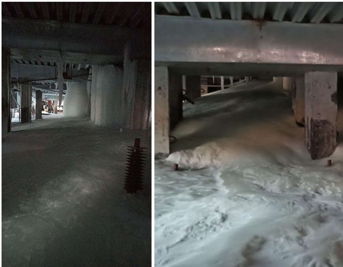
Рис. 1. Фото коммунальной аварии под зданием I в г. Салехард 02 февраля 2021 и 7 апреля 2021 года
