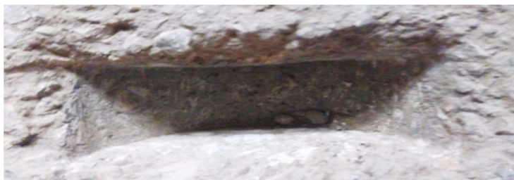
Рис. 6. След внедрения породоразрушающего инструмента в бетон
