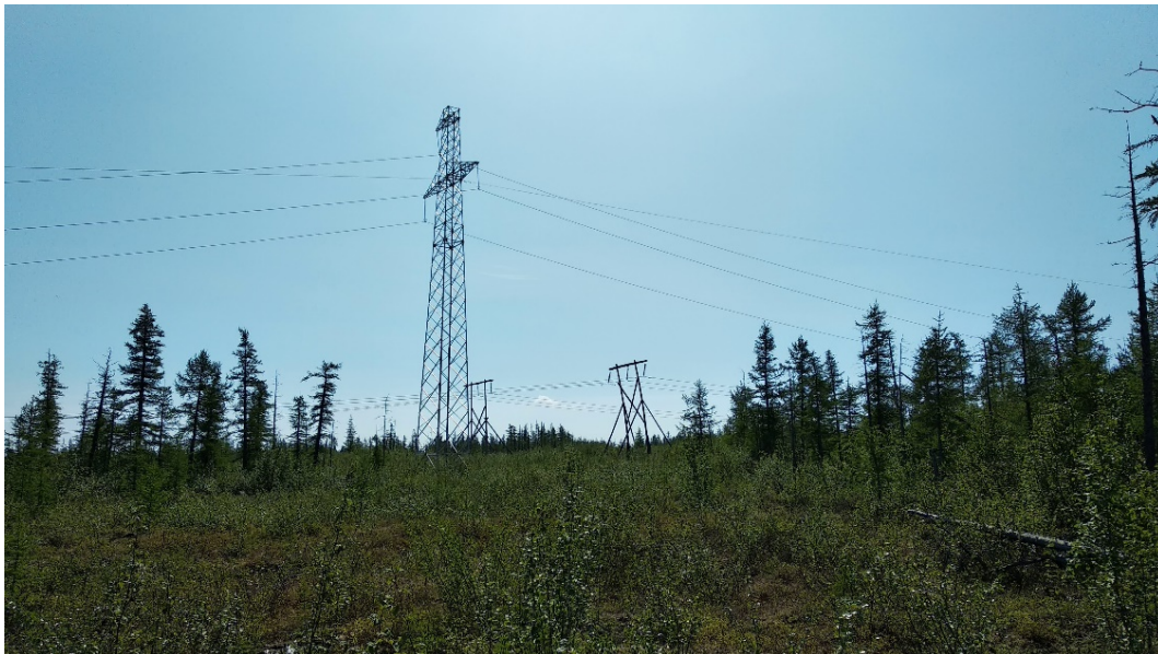
Рис. 8. Опора ВЛ 220 кВ
