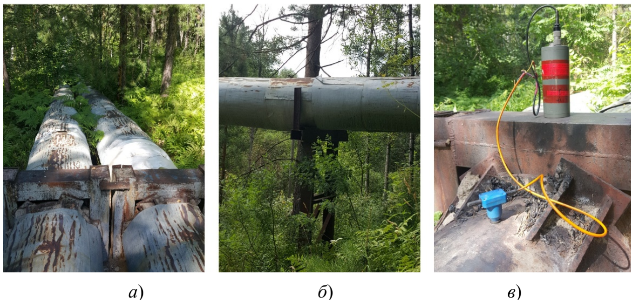
Рис. 1. Участок трубопровода с жестким креплением труб к опоре (а); трубы, уложенные на стойку без жесткого крепления (б); регистратор и установленный на трубе геофон (в)
