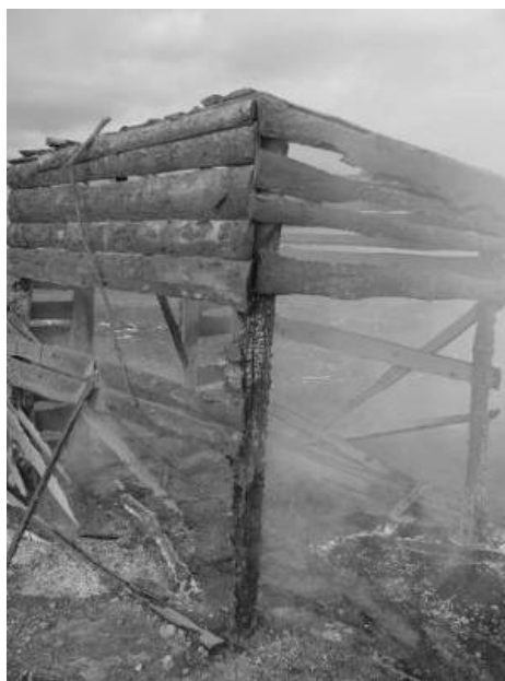
Рис. 5. Очаг пожара деревянного строения после тушения
