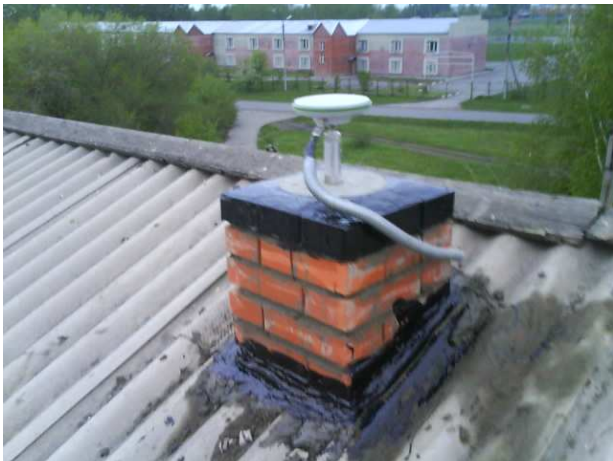
Рис. 3. Общий вид базовой станции (АБС)
