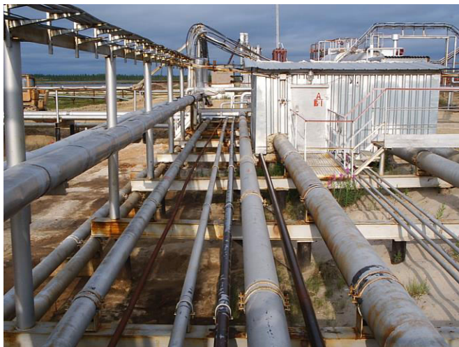
Рис. 1. Фотография насосной станции УКПГ
