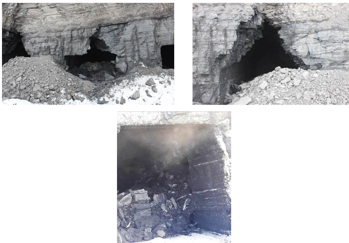
Рис. 7. Характер разрушения кровли камер и межкамерных целиков в натурных (производственных) условиях
